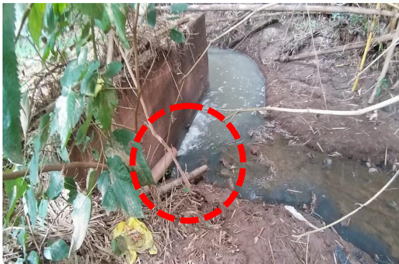
Figura 8 - Extravasor para o Rio da ETE Volta Redonda que será desativada (Bacia A).
