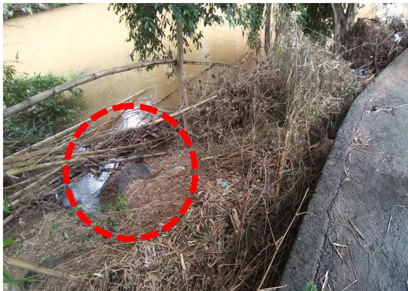
Figura 9 - Extravasor para o Rio da EEEB-A inoperante que será reconstruída (Bacia A).
