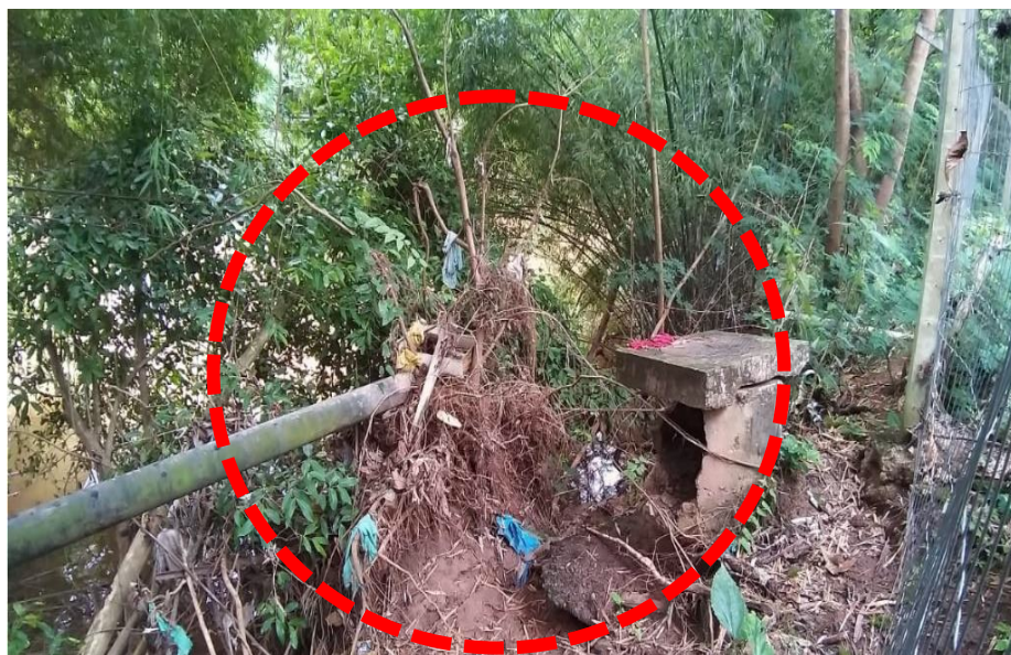
Figura 11 - Coletor beira-rio danificado e inoperante - Bacia A.
