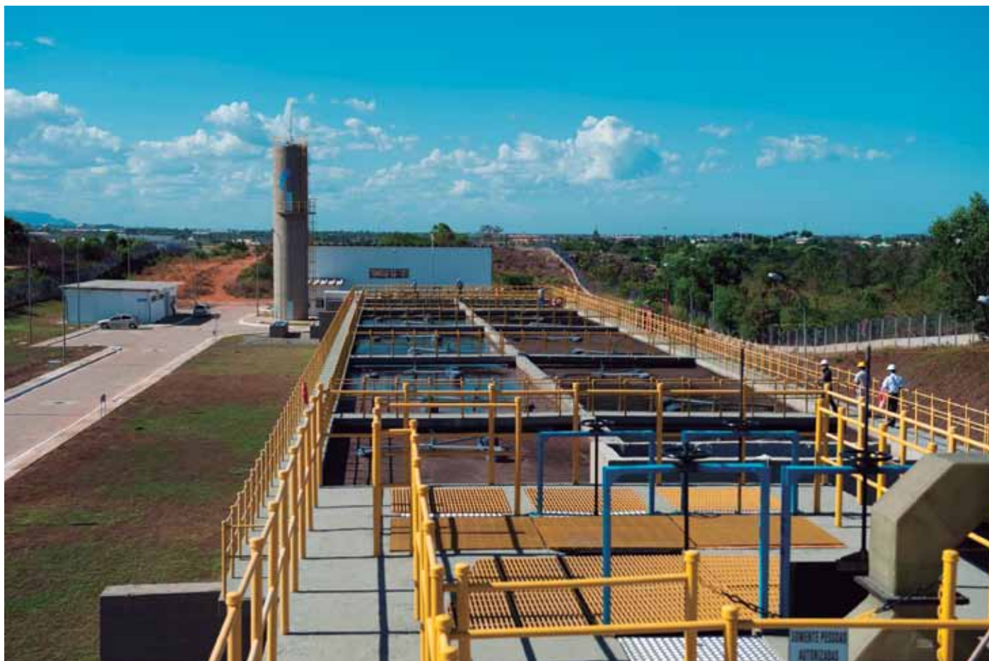
Estação de Tratamento de Esgoto Mangueiras, na Serra
