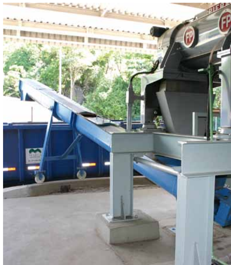
Coletor de lodo de esgoto na ETE Mulembá
