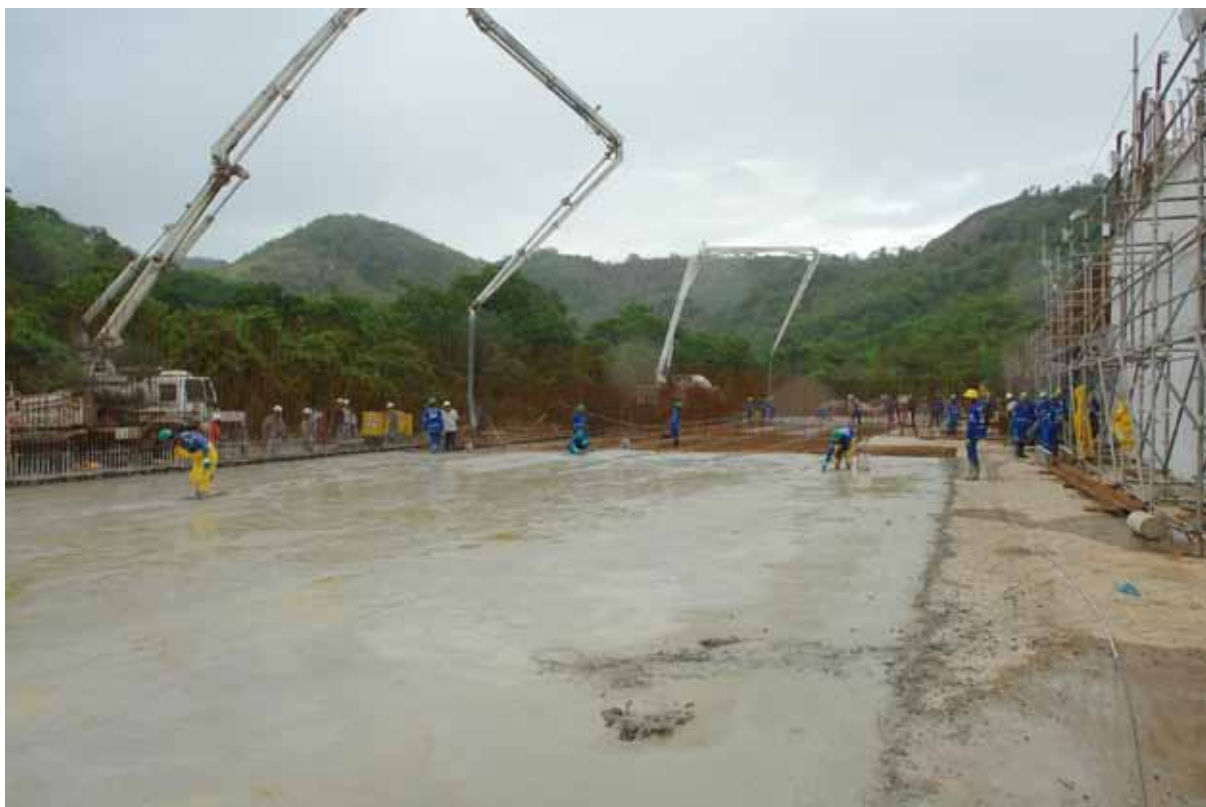
Ampliação da Estação de Tratamento de Esgoto Mulembá, em Joana D'Arc, Vitória
