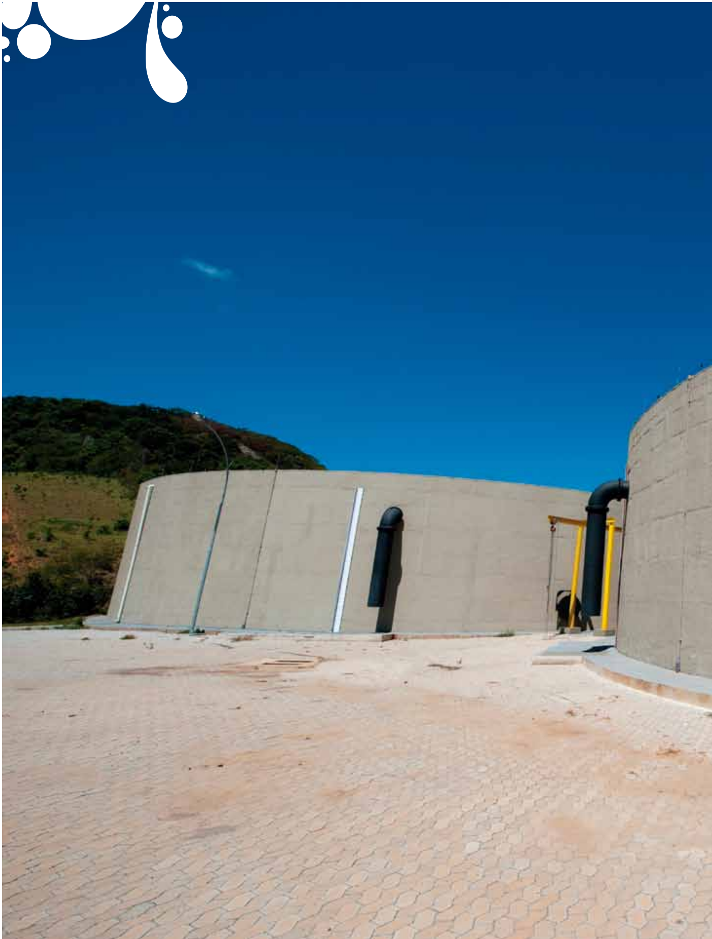
Reservatório de Água Morro do Pico, em Cariacica, com capacidade para 8 milhões de litros
