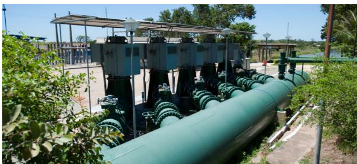
Elevatória de água na ETA Caçaroca, em Cariacica
