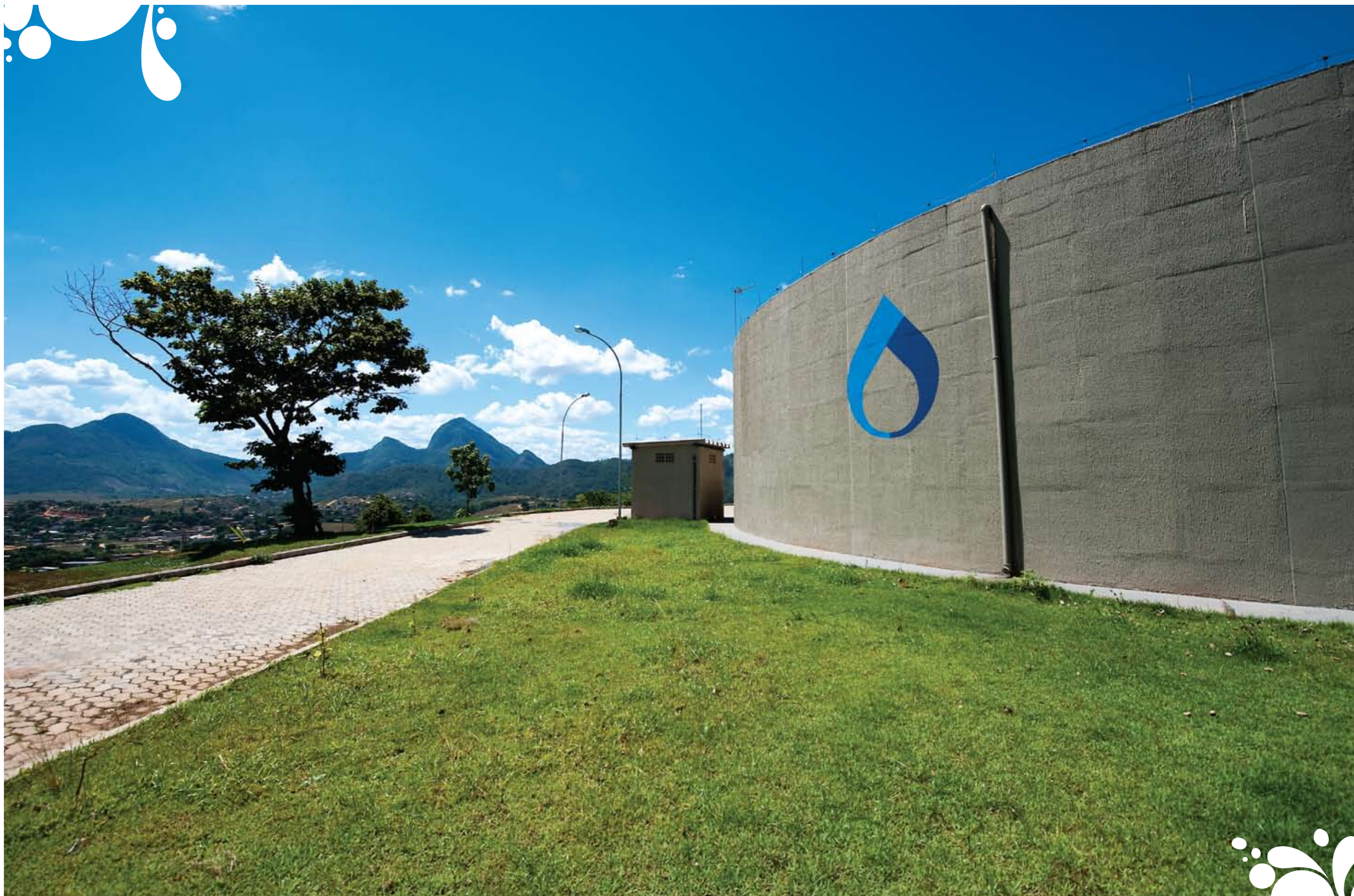
Reservatório de Água Morro do Pico, em Cariacica, com capacidade para 8 milhões de litros
