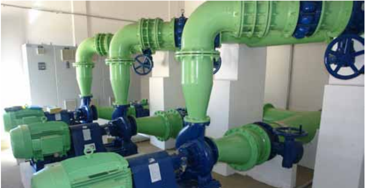
Elevatória de água tratada Pedreiras
