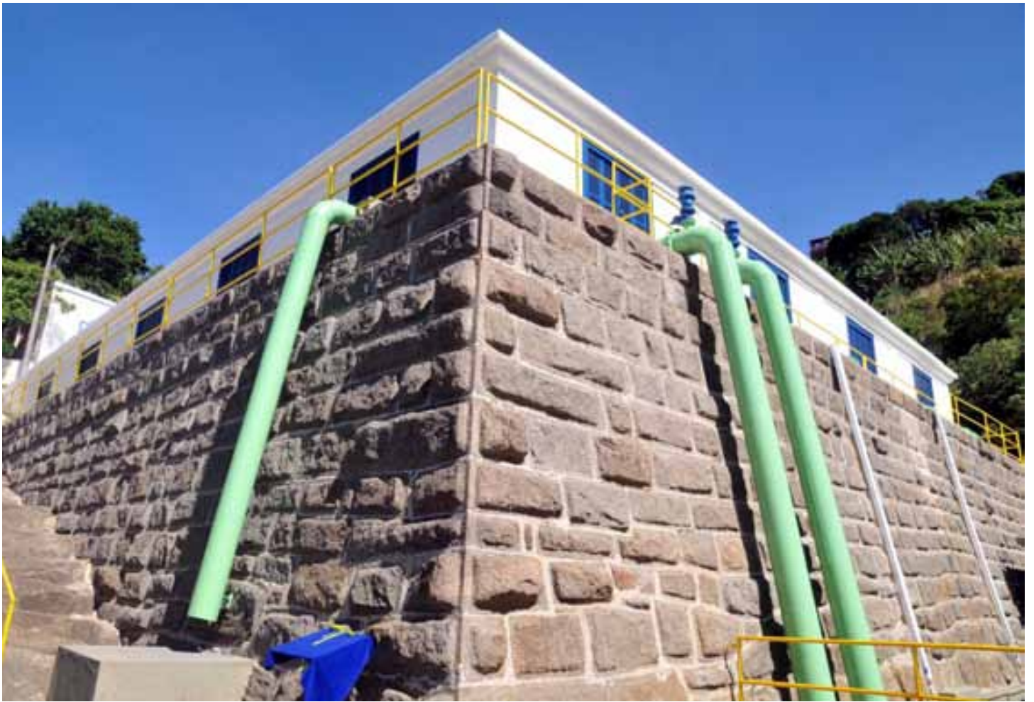
Reservatório Santa Clara, construído em 1909 e recuperado com recursos do Programa Águas Limpas
