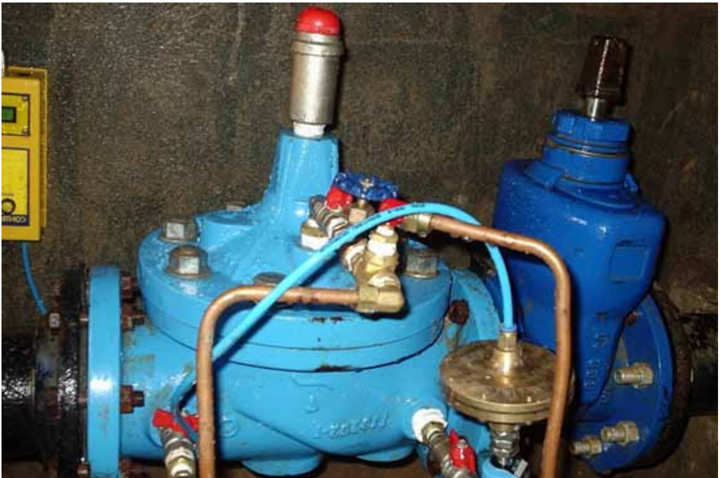
Válvulas redutoras de pressão (VRP), uma das soluções implantadas para diminuir perdas com vazamentos na rede
